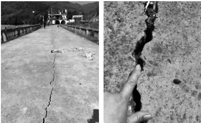
图 3 乌井水库坝顶纵向裂缝
