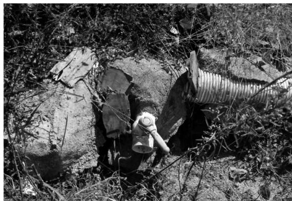
(b) 管道闸阀控制
