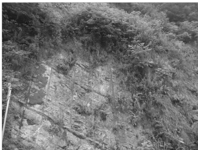
照片2 坡面岩土相对平整区域基材局部脱落情况
